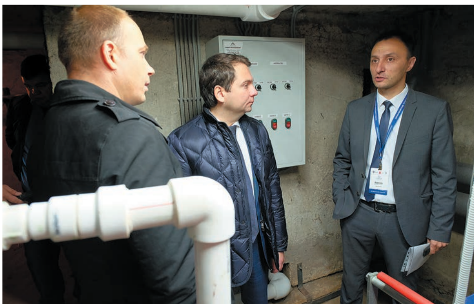
В подвале дома на ул. Академика Вавилова, 19
