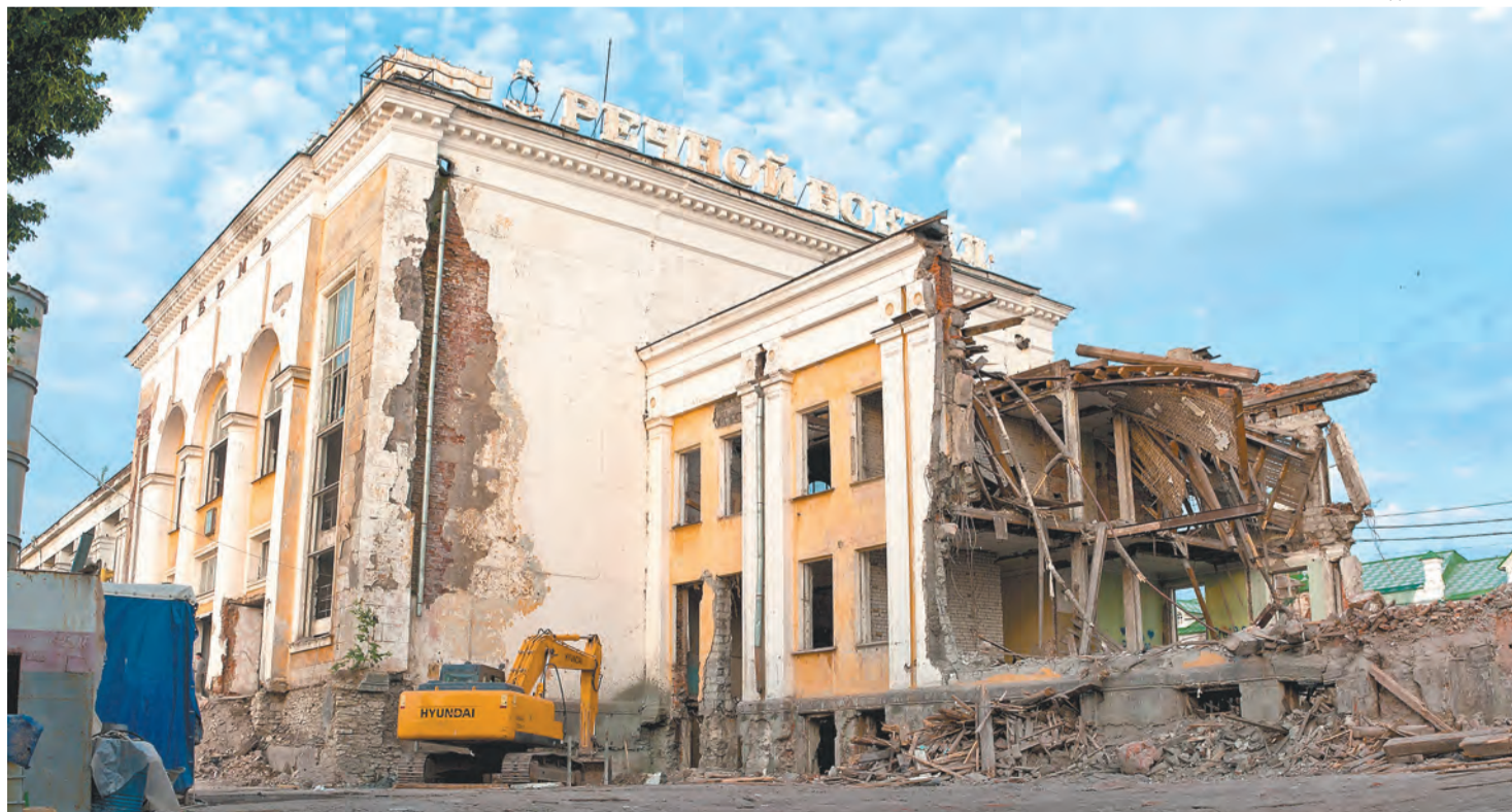
В процессе реконструкции Речного вокзала наиболее ветхое восточное крыло было полностью демонтировано
